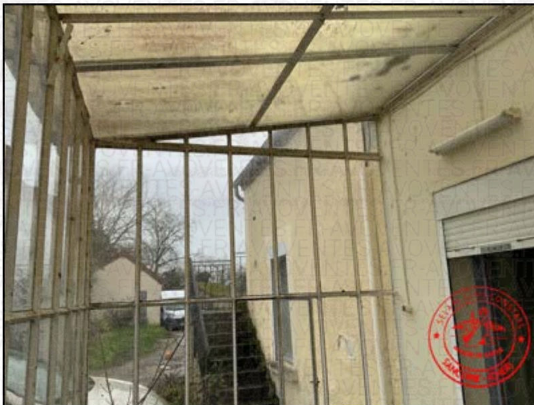
Photographie n°126. SELARL GIMS CONSTATS
