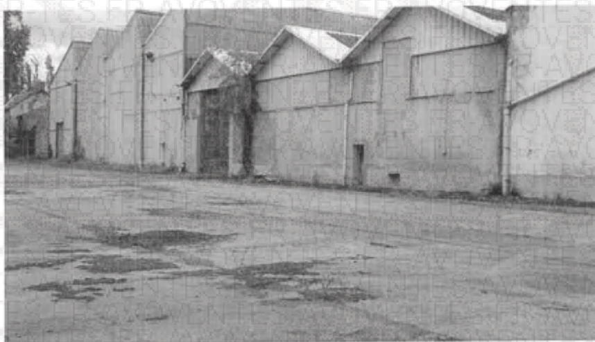
Couverture a priori en bac acier avec partie maçonnée toujours ancienne, porte ancienne, vétuste et bardage métallique de type bac acier en partie supérieure.
