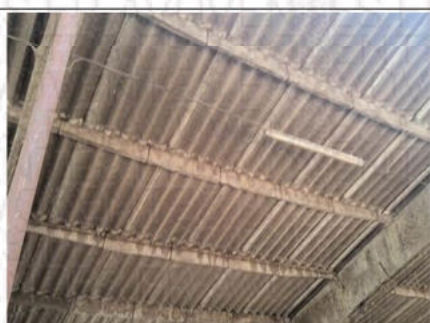
Photo n° PhA001 Localisation : Stabulation; Salle de traite; Stockage; Stabulation 2 Ouvrage : 1 - Couvertures, Toitures, Terrasses et étanchéités - Plaques ondulées et planes Partie d'ouvrage : Plaques en fibres-ciment (y compris plaques « sous tuiles ») Description : Plaques en fibres-ciment (y compris plaques « sous tuiles ») Localisation sur croquis : M001
