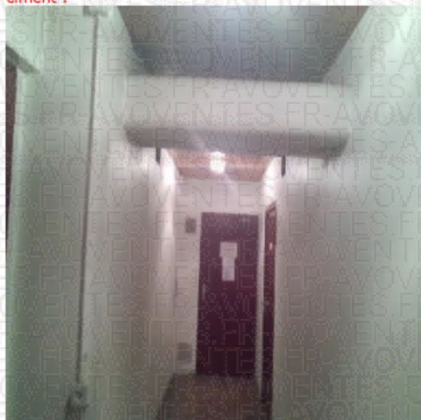
sous sol / dégagement ascenseur / gaine ventilation amiante ciment :
