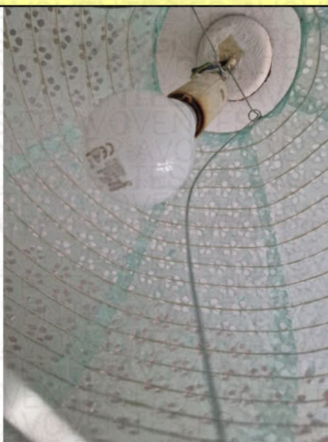
Douille vétuste avec traces d'échauffement
