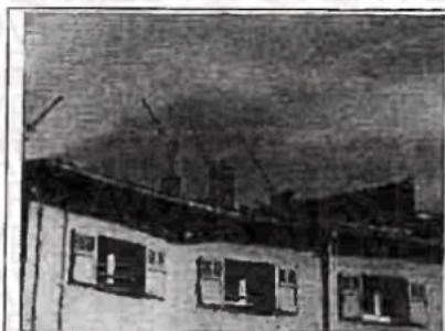
Photo n° Ph001 Localisation : Toiture Ouvrage : Conduits, canalisations et accessoires intérieurs et extérieurs - Conduits de fluides (air, eau, vapeur, fumée, autres fluides) Partie d'ouvrage : Conduit Description : Conduits
