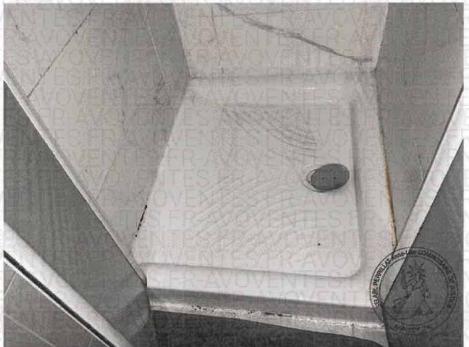
Le receveur de douche est à l'état d'usage.
