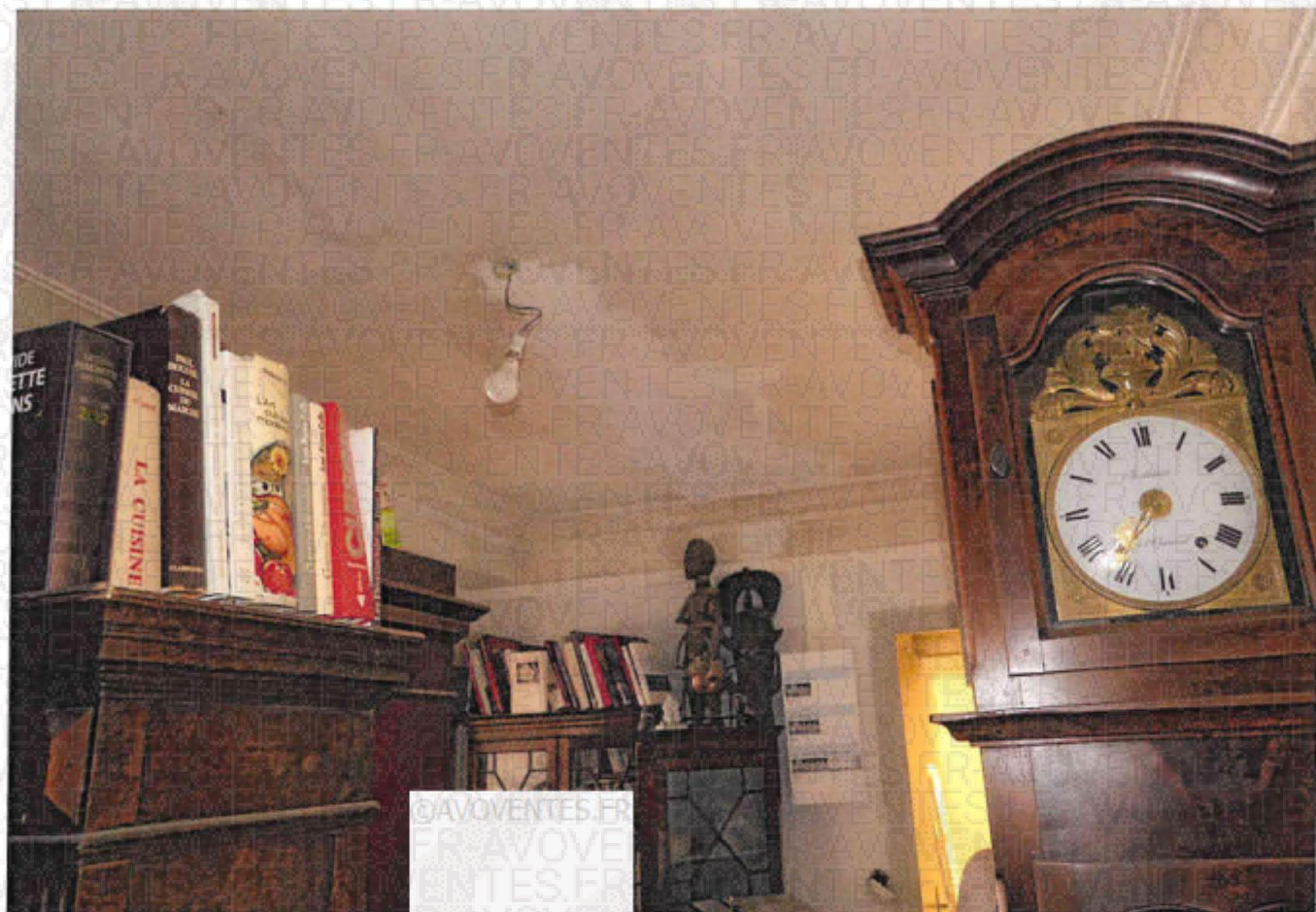
hall entrée plafond photo 9
