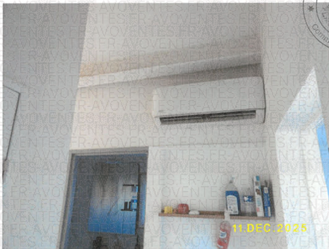
Photo 27 – Split de climatisation à l'étage
