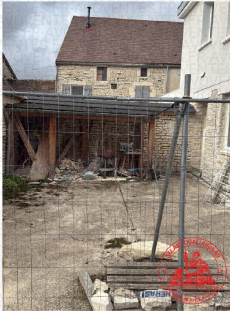
Façade arrière de l'immeuble correspondant aux différentes ouvertures donnant sur une cuisine en pierre jointoyée au niveau du rez-de-chaussée, recouverte d'un enduit de couleur blanche en bon état dans l'ensemble.
