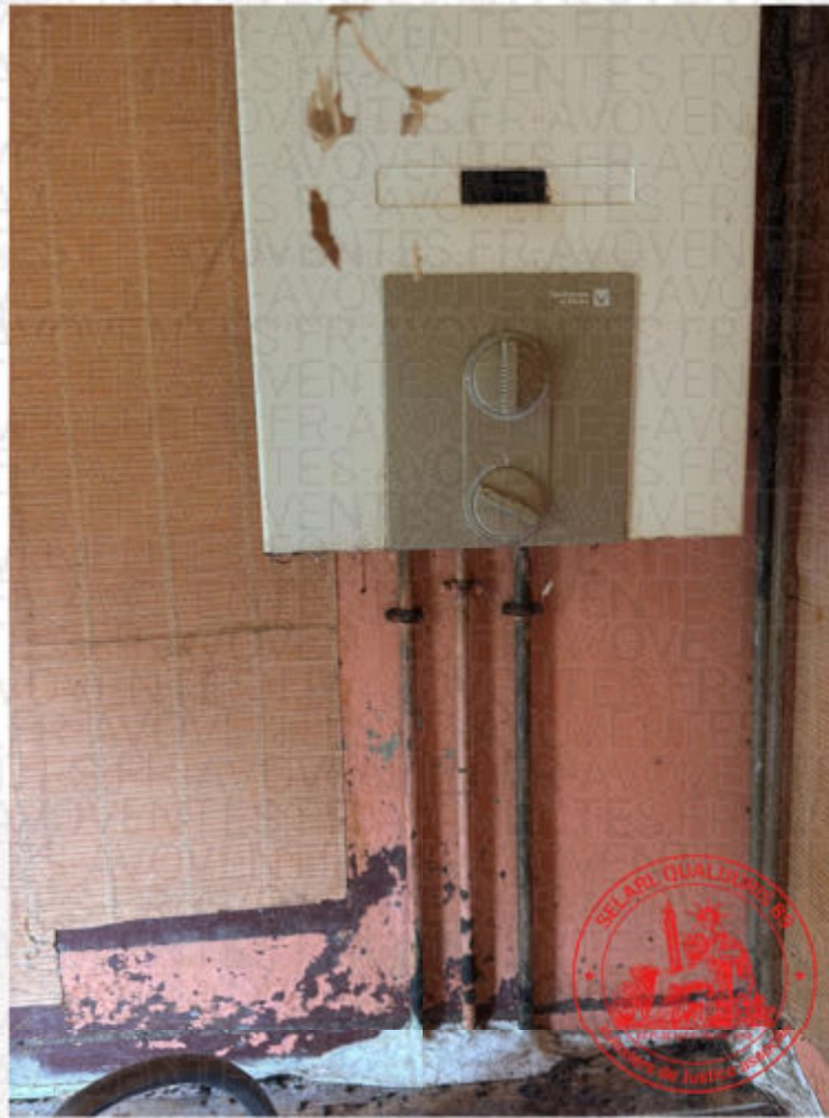
Une hotte aspirant en très mauvais état général
