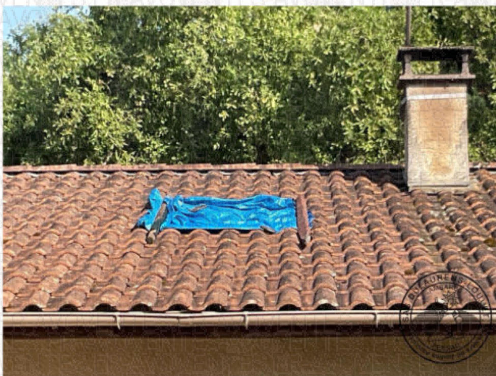
Bâche temporaire en toiture
