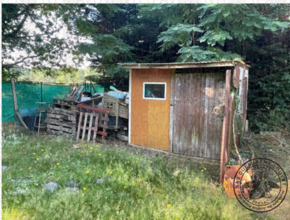
Cabanon de jardin, absence de dalle béton
