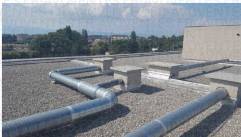
Réseau de ventilation en toiture
