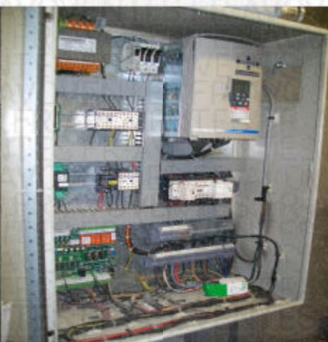
L'armoire de manoeuvre.
