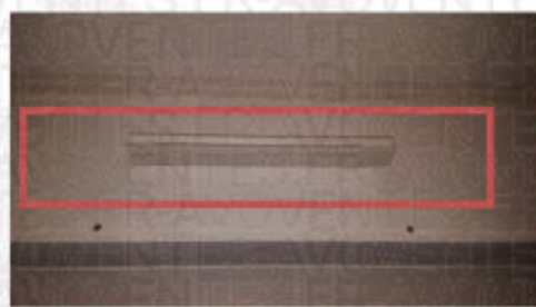
Bouche d'entrées d'air des menuiseries
