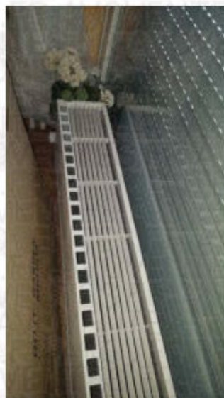
Radiateurs dani: les appartements
