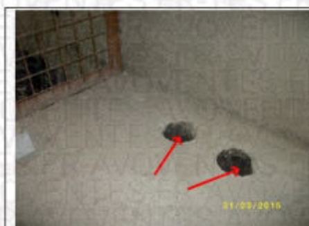
Photo n° PhA008 Localisation : 8ème étage - Machinerie ascenseur 46C Ouvrage : Conduits, canalisations et accessoires intérieurs et extérieurs - Conduits de fluides (air, eau, vapeur, fumée, autres fluides) Partie d'ouvrage : Conduit Description : Conduit (oureaux passage cables ascenseur) Localisation sur croquis : 009
