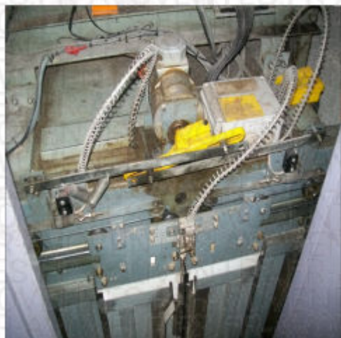
L'opérateur de porte cabine.
