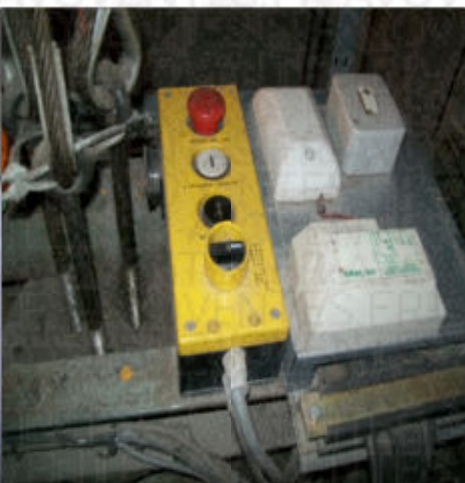
Le boîtier d'inspection.
