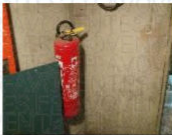
Extincteur à l'entrée de la chaufferie
