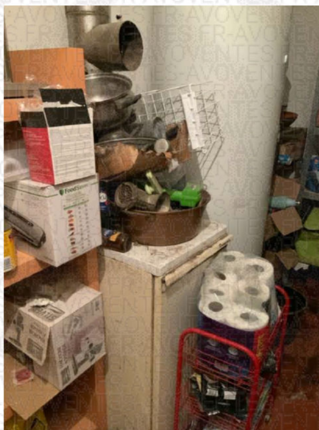
5. Chaudière au fuel hors d'usage
