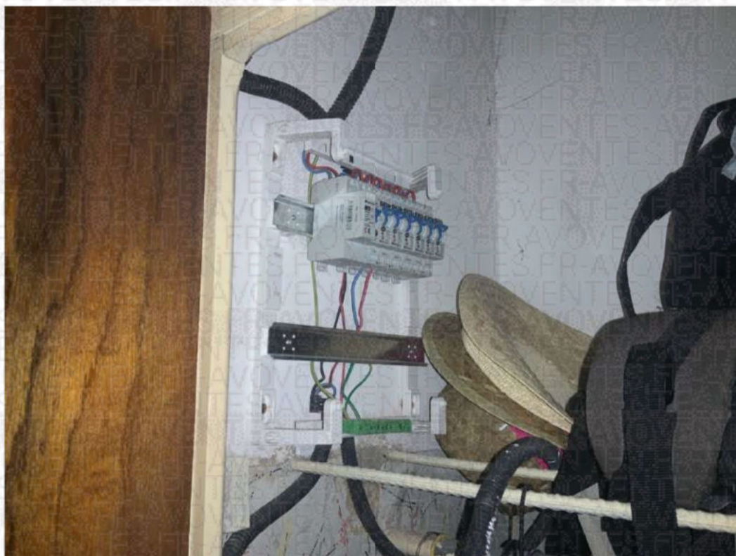
3. Tableau électrique du placard
