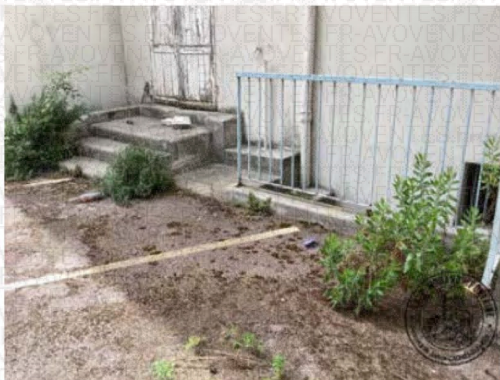
Des barrières en métal (rouillé) bordent deux sections d'escalier.
