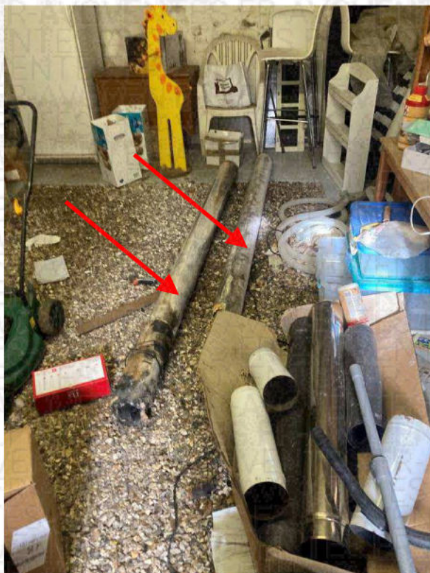
Cave : 2 conduits de fluide amiantés
