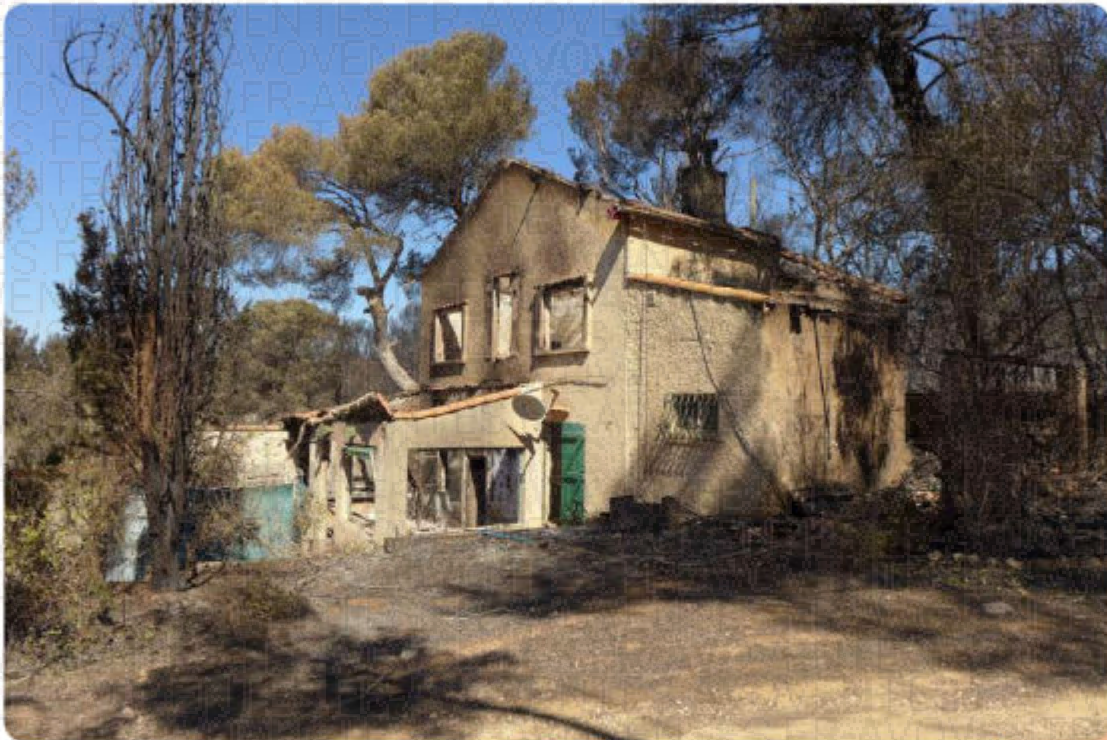
Maison non débroussaillée, partiellement détruite par le passage d'un feu, Rognac (13), source : ONF.
