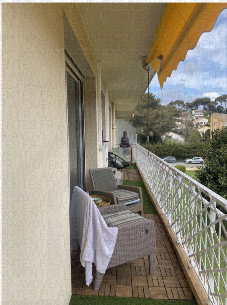
Terrasse exposée Est : Deux stores bannes manuels en bon état.
