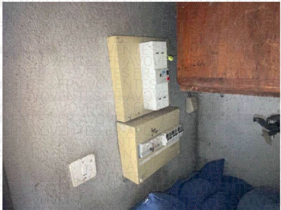
Photographie n°35. Tableau électrique et disjoncteur général
