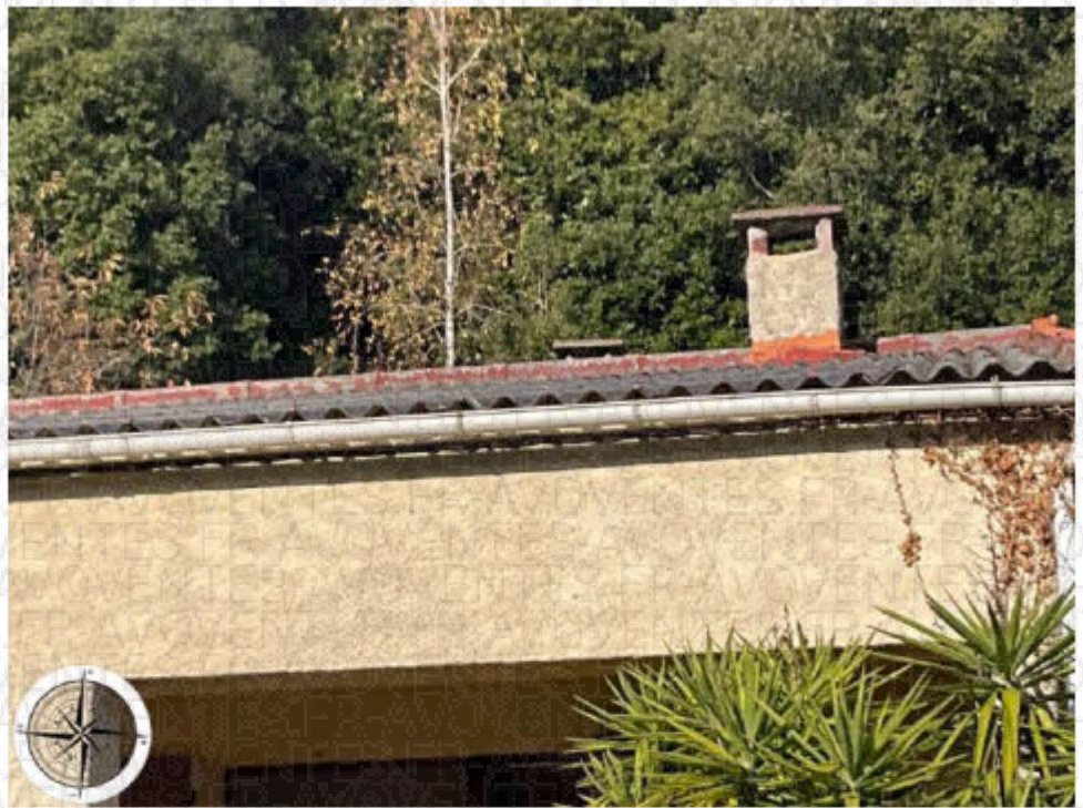
Photographie n°19: couverture du toit de la villa : tôles en fibro-ciment, sans couverture de tuiles
