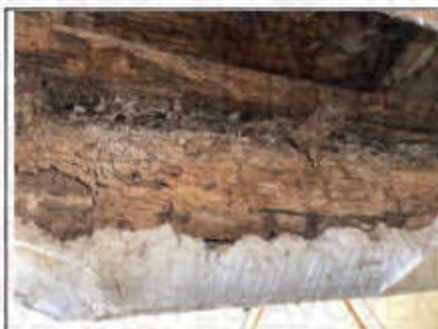
Photo n° PhTer001 Localisation : 4ème étage - Grenier 4 Ouvrage : Poutres Parasite : ---- Insectes à larves xylophages ---- Indices : présence de trous de sortie, présence de vermoulure (dégradation(s) importante(s), infestation(s) importante(s), présence étendue, présence sur tout l'élément concerné)
