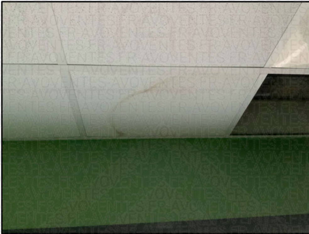
Photographie n°10. Type d'auréole visible sur plusieurs dalles situées à l'aplomb du panneau 2 c'est-à-dire au niveau de l'emplacement des fenêtres.
