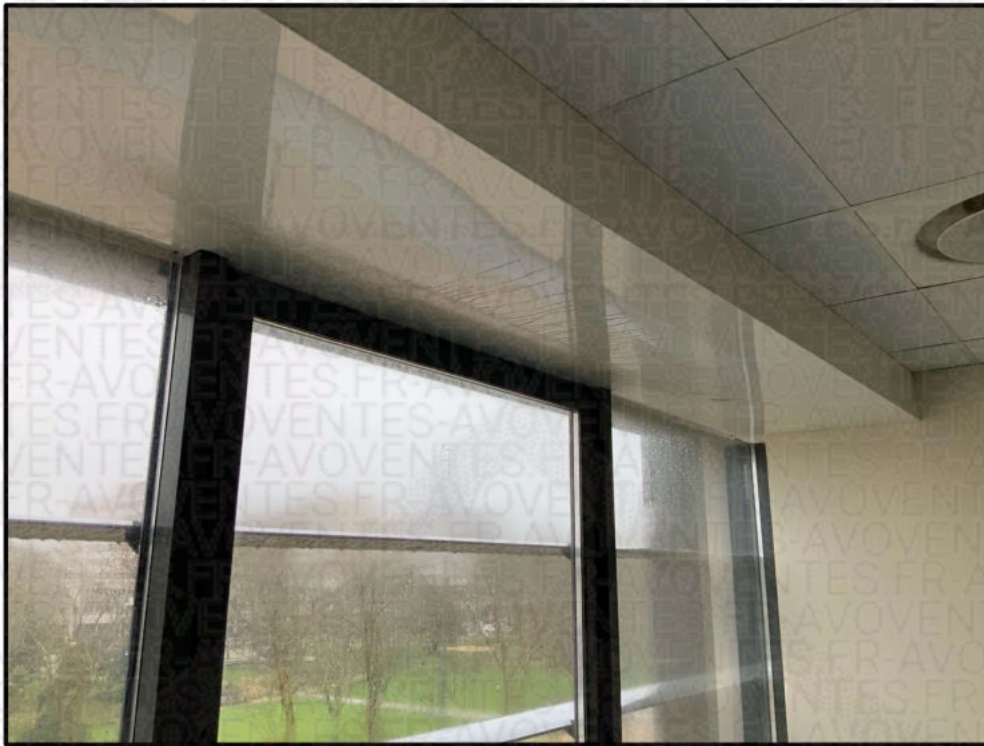
Photographie n°18. Traces de coulures (Pluies ?) au niveau de la fenêtre qui fonctionne mal.
