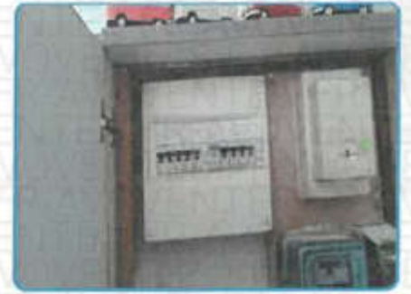
Anomalie B.4.3 i sur Install. n°1 (AGCP) PROTEC.DIFF. sur Install. n°1 (dans Appartement Rez de chaussée Pièce à vivre) TRP n°1 sur install. n°1 (dans Appartement Rez de chaussée Pièce à vivre)
