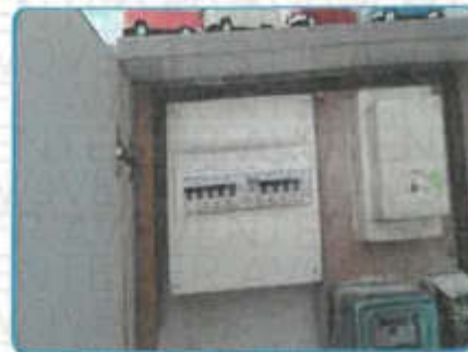
Anomalie B.4.3 i sur Install. n°1 (AGCP) PROTEC.DIFF. sur Install. n°1 (dans Appartement Rez de chaussée Pièce à vivre) TRP n°1 sur Install. n°1 (dans Appartement Rez de chaussée Pièce à vivre)
