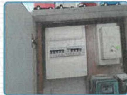
Anomalie B.4.3 i sur Install. n°1 (AGCP) PROTEC.DIFF. sur Install. n°1 (dans Appartement Rez de chaussée Pièce à vivre)
