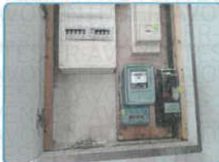
COMPTEUR sur Install. n°1 (dans Appartement Rez de chaussée Pièce à vivre)
