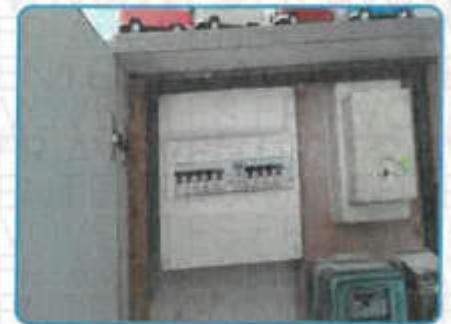
Anomalie B.4.3 i sur Install. n°1 (AGCP) PROTEC.DIFF. sur Install. n°1 (dans Appartement Rez de chaussée Pièce à vivre) TRP n°1 sur Install. n°1 (dans Appartement Rez de chaussée Pièce à vivre)
