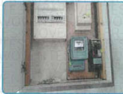
COMPTEUR sur Install. n°1 (dans Appartement Rez de chaussée Pièce à vivre)
