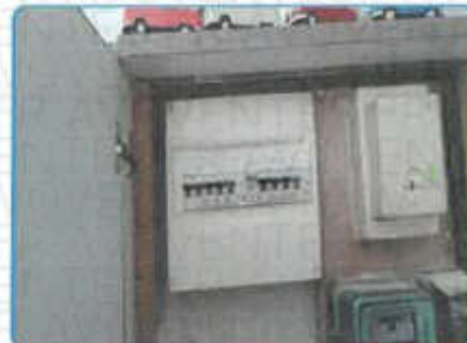
Anomalie B.4.3 i sur Install. n°1 (AGCP) PROTEC.DIFF. sur Install. n°1 (dans Appartement Rez de chaussée Pièce à vivre) TRP n°1 sur Install. n°1 (dans Appartement Rez de chaussée Pièce à vivre)
