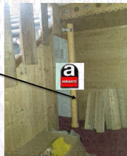
coffrage perdu de type fibre-ciment amiante
