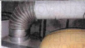
Photo n° PhGaz001 Localisation : Garage Chaudière FRISQUET (Type : Raccordé)
