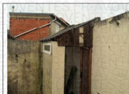
Photo n° PHA001 Localisation : Rez de chaussée - Abri Ouvrage : Toitures Partie d'ouvrage : Plaques (fibres-ciment) Description : Plaques (fibres-ciment) Localisation sur croquis : M001
