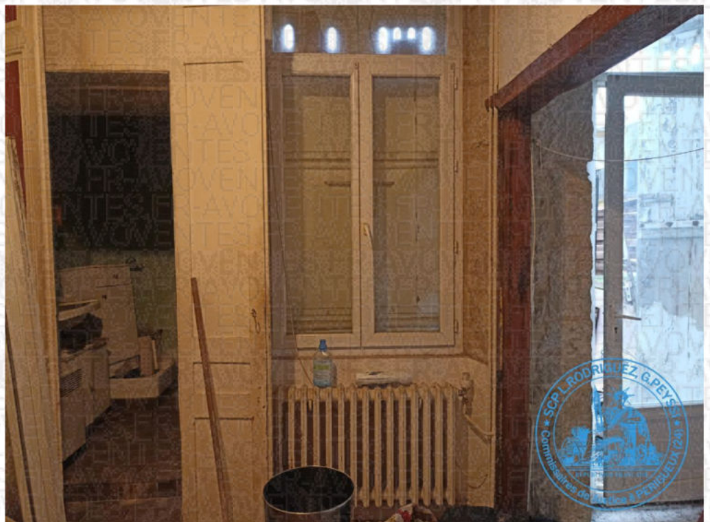
Côté séjour est visible un radiateur de chauffage central encrassé et une fenêtre en pvc avec double vitrage et volets en bois
