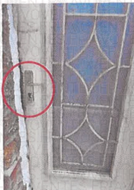
Photo 15 : Signe d'effraction sur le pavillon situé au 105 avenue Le Foll
