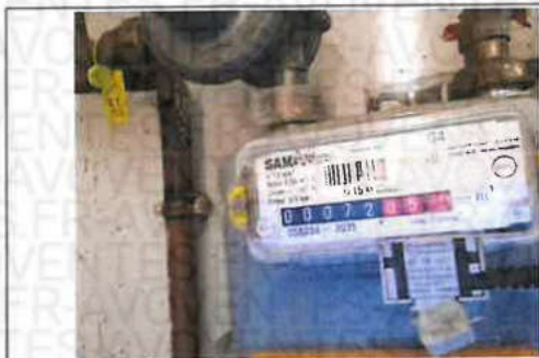
Photo n° du Compteur Gaz
