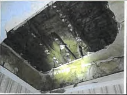
Photo n° PhTer006 Localisation : Salon musique Ouvrage : Plafond Parasite : --- Champignons lignivores ---, Champignon de pourriture cubique du type méréule pleureuse ( Serpula lacrymans )(humidité peu importante) Indices : présence de fructification, présence de spore (dégradation(s) importante(s))
