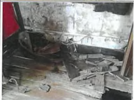
Photo n° PhTer005 Localisation : RdC - Salon Ouvrage : Plancher et murs Parasite : --- Champignons lignivores ---, Champignon de pourriture cubique du type méréule pleureuse ( Serpula lacrymans )(humidité peu importante) Indices : dégradation du bois, présence de filaments (ou hyphes) (dégradation(s) importante(s))
