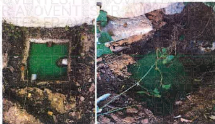
Regards contre la maison
