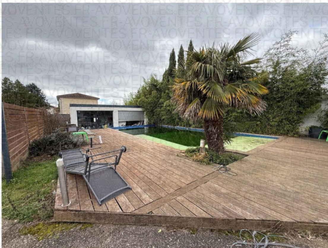
Terrasse en lambris en mauvais état, piscine non entretenue.
