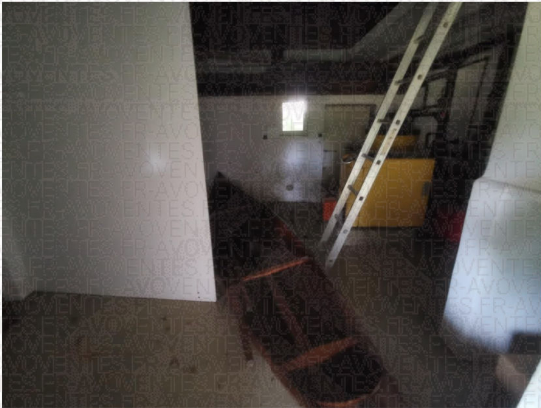
Présence de la chaudière dans le bâtiment attenant.
